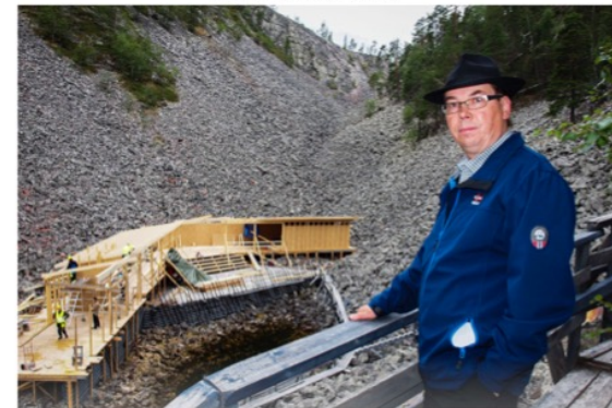
Pelkosenniemen tekninen johtaja Panu Leinosen mukaan kunnan osuus peruskorjaushankkeesta on noin 34 000 euroa, jonka lisäksi kunnostustöitä tehdään joka vuosi.
